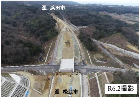
【写真①】出雲・湖陵道路、湖陵・多伎道路湖陵IC(仮称)付近の施工状況
