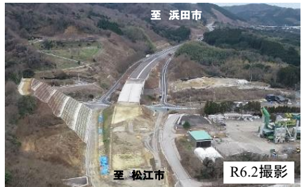
【写真②】湖陵・多伎道路出雲多伎IC付近の施工状況
