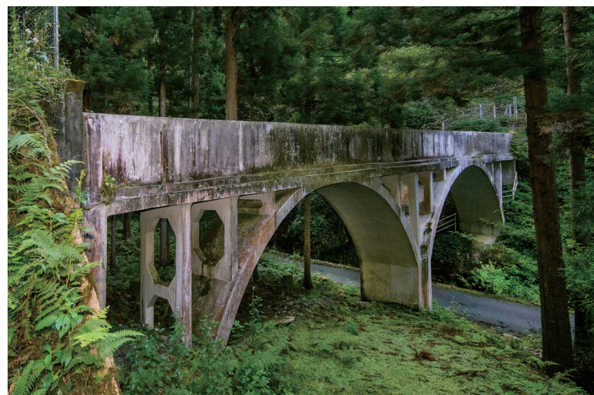
本谷川水路第4水路橋(RC開腹アーチ、長さ39.45m、幅1.35m、高さ7.3m)等間隔にたつ3本の橋脚の間から円弧状のアーチがおきる
