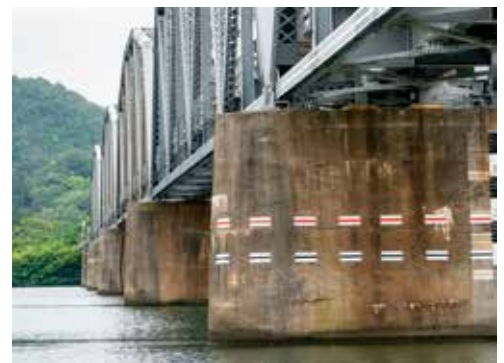
大正時代になり橋脚はレンガ・石積みからコンクリート製になっていく
