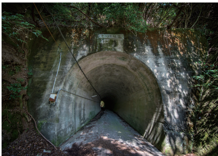
包ヶ浦隧道 トンネル点検後、崩落の危険性があるため現在は通行禁止
