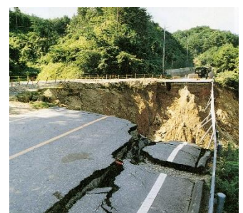
大きくえぐられた国道 9 号（島根県浜田市三隅町）
