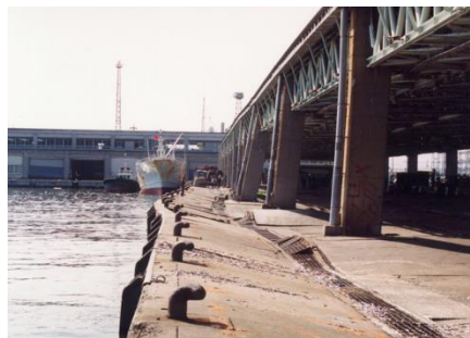
傾いた港湾施設の床面と柱（鳥取県境港市）
