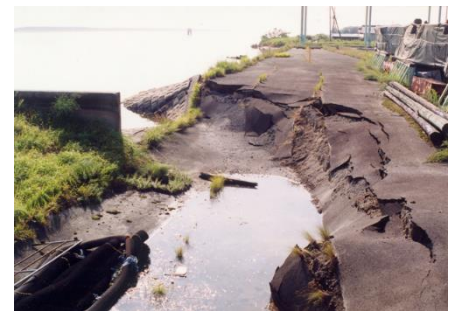
陥没した干拓地の堤防（島根県松江市）
